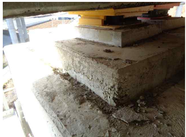
P3-Sh1 받침콘크리트 재료분리 (1.0m×0.4m)
