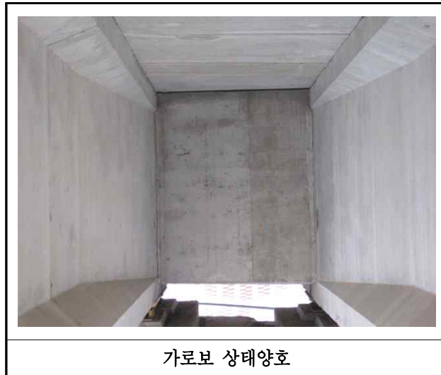
【사진 16.3.7】 가로보 손상현황
