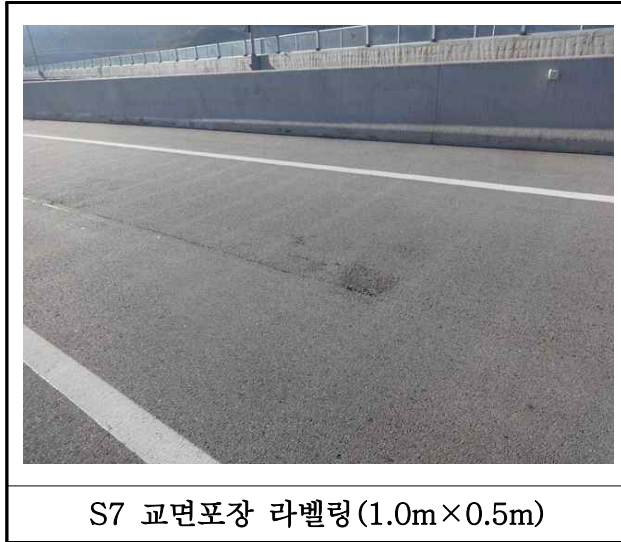
【사진 16.3.20】 교면포장 손상현황
